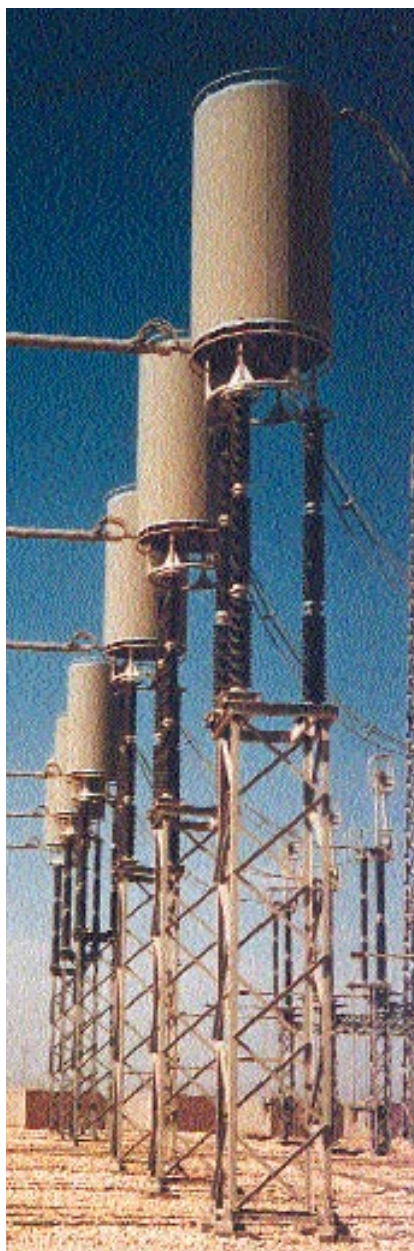
Рис. 1. ВЧ заградители, установленные на опорах.
